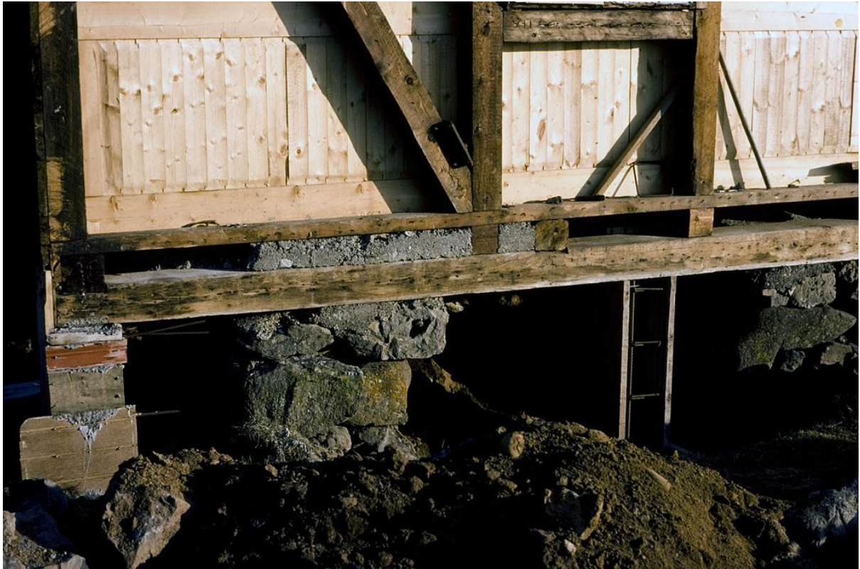
Mynd 12. Þrjár myndir sem sýna gerð og frágang við undirstöðustöpla kirkjunnar (Skg.-4969, 4971 og 4970).
